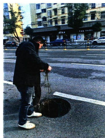
DA005 雨水排口
